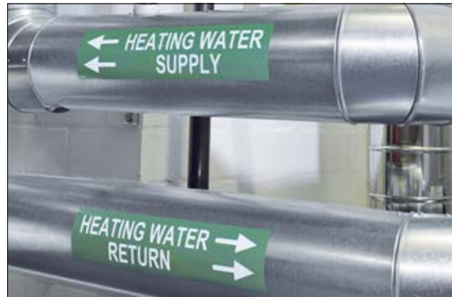
Duże i dobrze widoczne oznakowanie rur.
