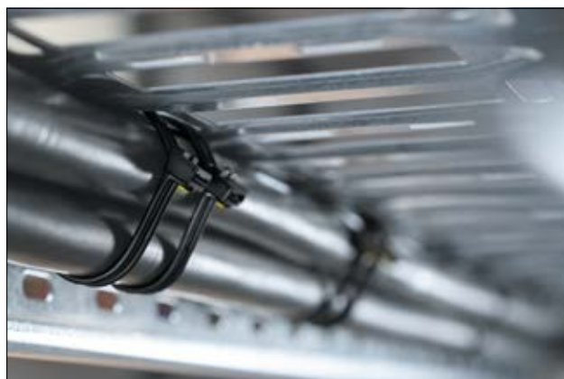
Opaski serii KR zastosowane w korytku kablowym.
