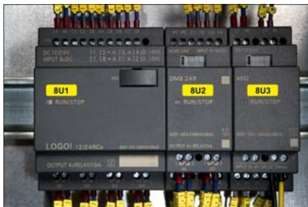
Zastosowanie w rozdzielni.
