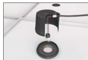
2. Podłącz zasilanie do gniazda lampy za pomocą złączek HelaCon Lux i zamocuj za pomocą złączki bagietowej.
